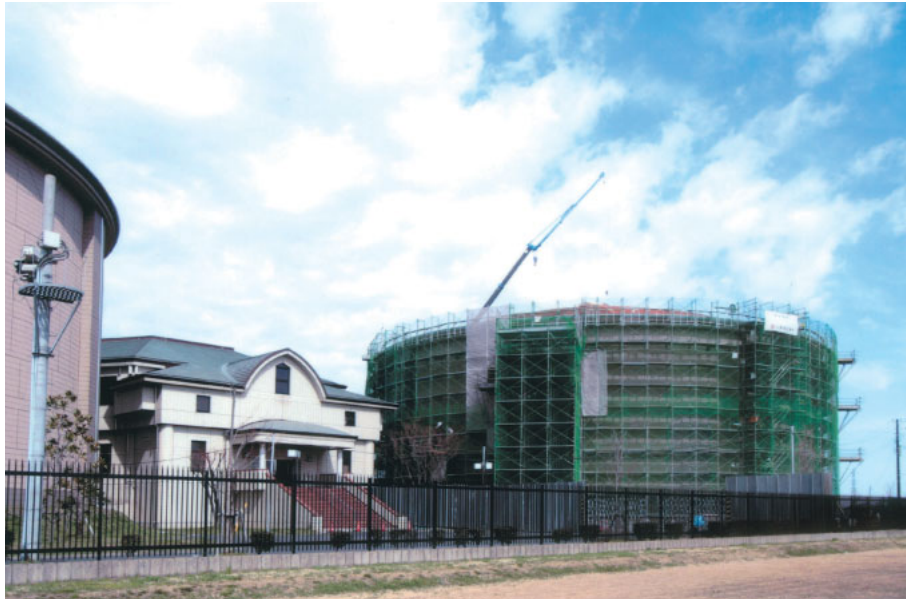
西部配水場に建設中の2号配水池。容量は18,000m 3 で県営新三郷浄水場から受水する。5月に完成後、西部配水場は36,000m 3 の貯水容量となり、越谷市北西部から南部地域への配水の中心的役割を担う。
